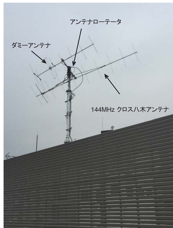
図12 実験棟屋上に設置した144MHzクロス八木アンテナシステム
