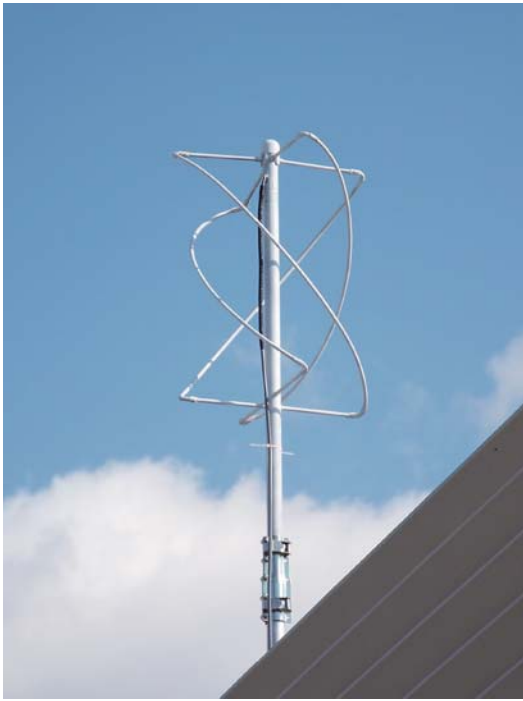
図10 研究棟屋上に設置したQFHアンテナ
